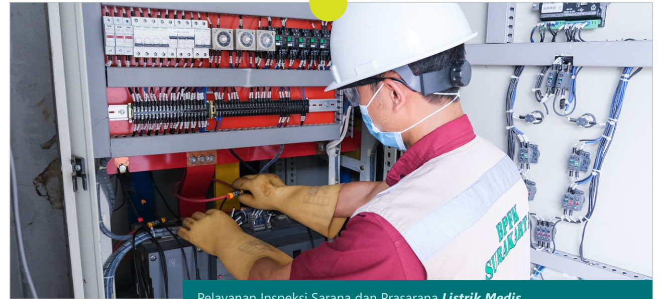
Pelayanan Inspeksi Sarana dan Prasarana Listrik Medis
