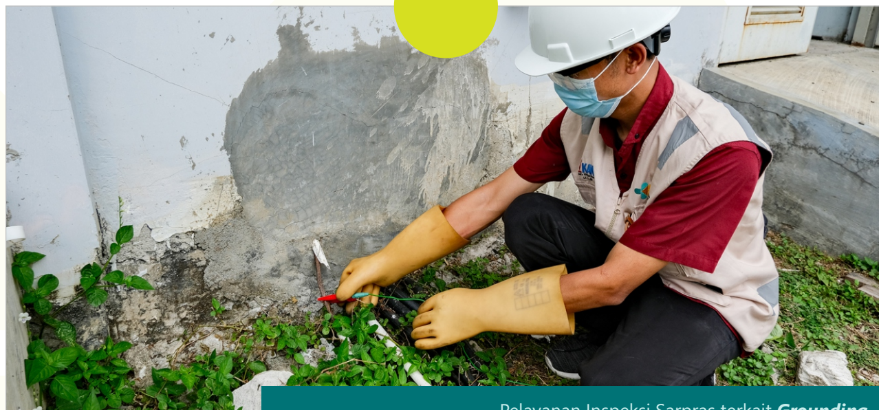
Pelayanan Inspeksi Sarpras terkait Grounding
